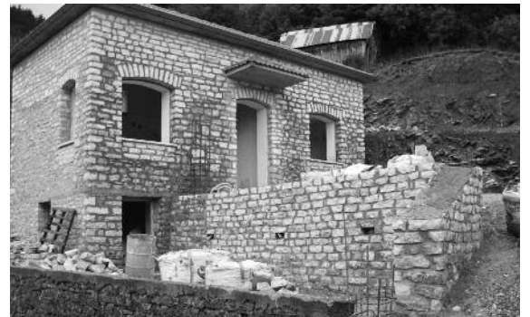
Έγινε αρμολόγημα όλων των εξωτερικών επιφανειών του ξενώνα μας. Οι κ.κ. Έλλη Καλύβα, Μαγδ. Καλύβα και Φ. Ντανά φρόντισαν τους εργατές.
